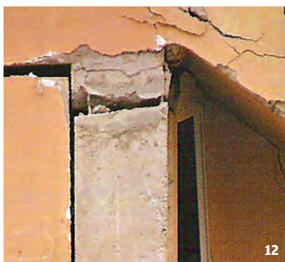
Fig. 11: fisuras por flexión.
