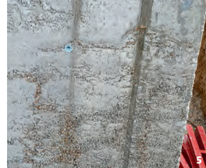
Fig. 3: deficiente replanteo y grifado de armaduras.
