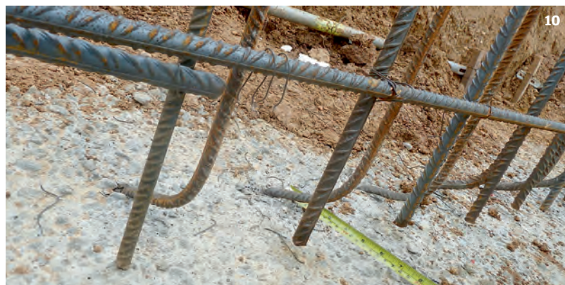
Fig. 10: grifado excesivo de las armaduras en espera del muro.
