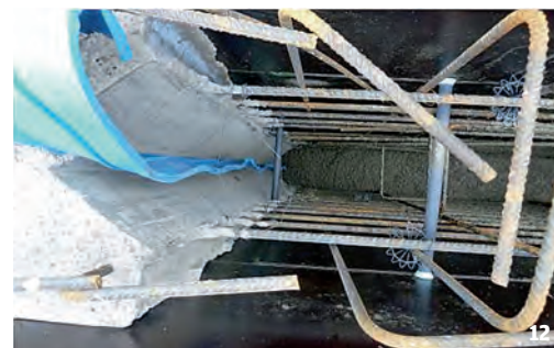
Fig. 12: junta de hormigonado y retracción.
