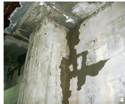
Fig. 4: muro de sótano. Filtración.
