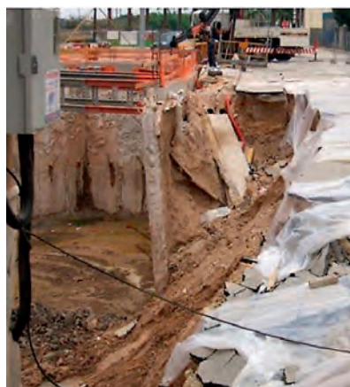
Figura 4: patología en pantalla.
