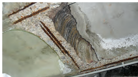
Figura 8: fisuras por corrosión de las armaduras.
