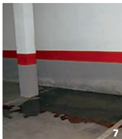
Fig. 7: filtración por el encuentro solera-muro.
