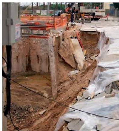
Figura 4: patología en pantalla.
