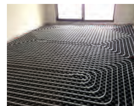
SUELO RADIANTE PARA CLIMATIZAR
